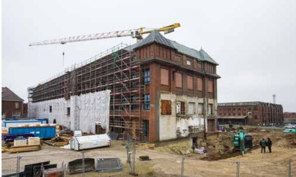
Spektakulärer Umbau hinter denkmalgeschützter Fassade: Auf dem Gelände der ehemaligen Bremer Wollkämmerei in Blumenthal entsteht ein moderner Berufsschulcampus.
